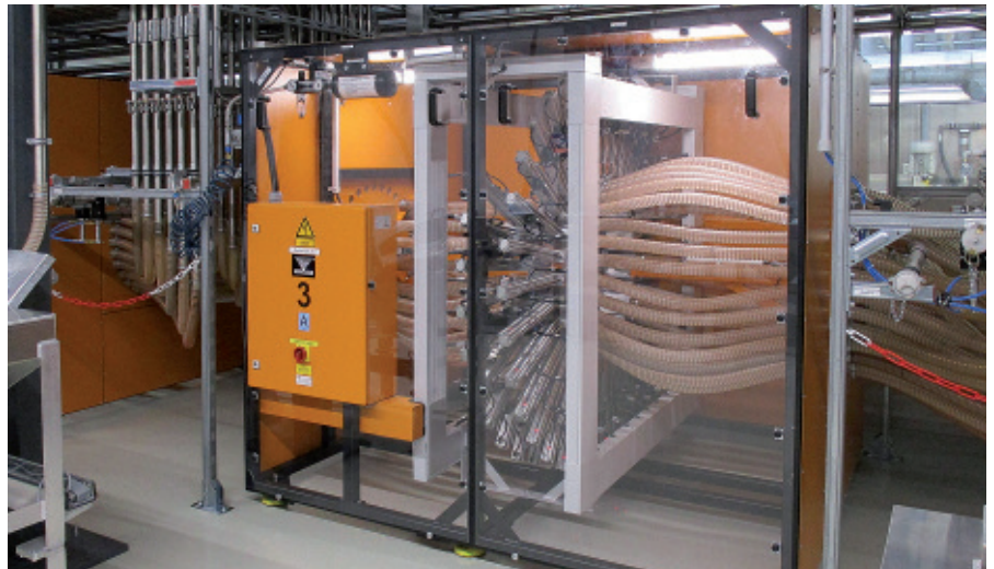
Materialverteilung: Über die »Navigatoren« kann jede Bedarfsstelle in der Spritzerei mit jedem vorbereiteten Material versorgt werden.
