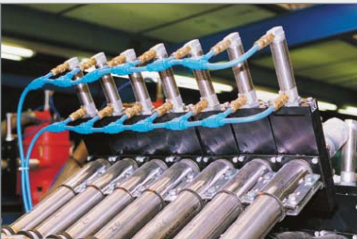
Vannes de vidange de ligne
