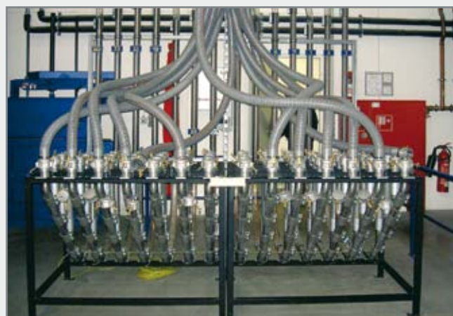
Cette double station de dérivation assure la distribution de 14 matières
