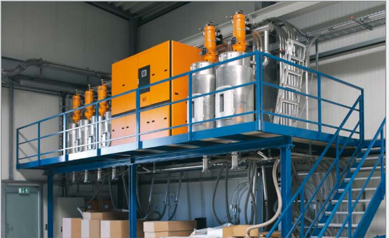
Un des trois dessiccateurs CKT 800 installés chez un sous-traitant automobile
