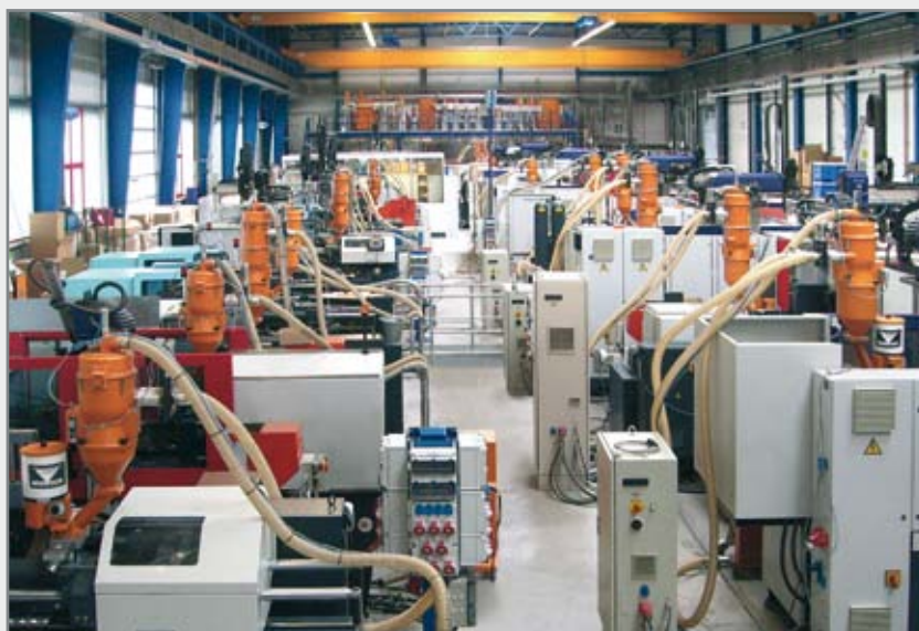
Alimentation centralisée avec séchage central (trois dessiccateurs CKT avec cuves de séchage sont visibles en arrière-plan), appareils de dosage et colorateurs directs
