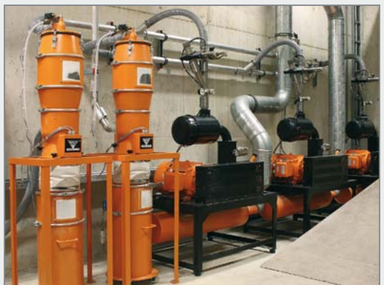
Pompe à vide de 11 kW et filtres de sécurité Sa3 avec bac de récupération des fines de 60 litres
