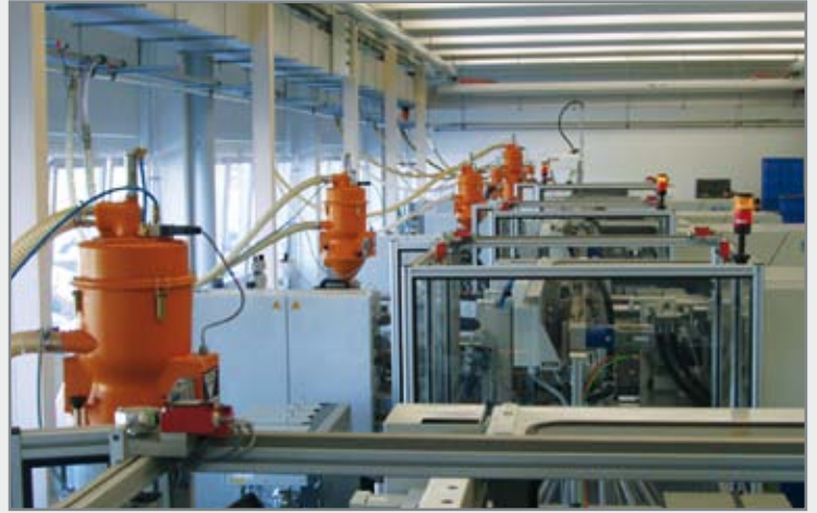
Alimentation centralisée avec séparateur A 8 + Z 5
