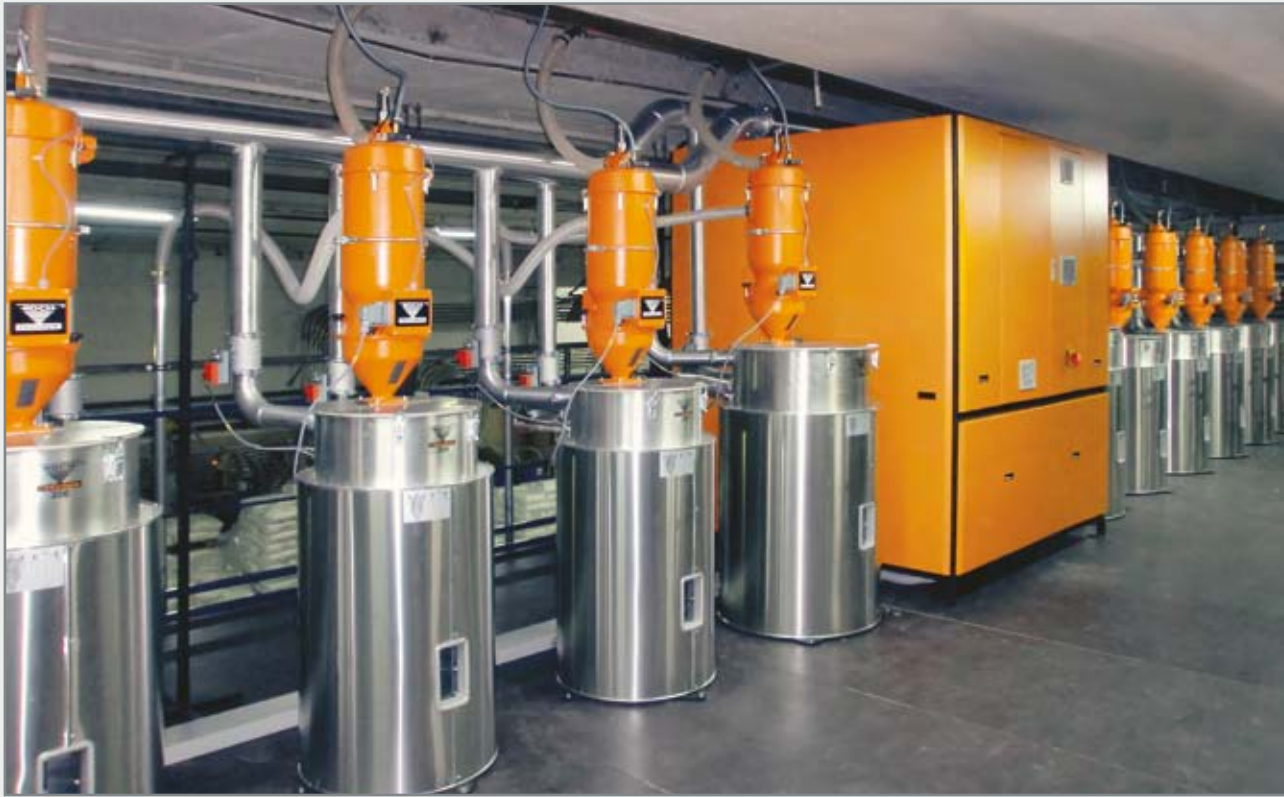
Dessiccateur à air sec CKT 1000 avec cuves de séchage de 200 litres, intégrés dans l'alimentation centralisée d'un fabricant de jouets
