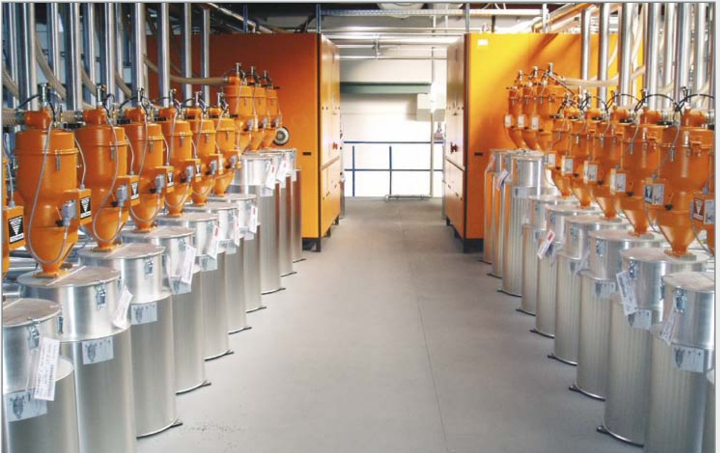
Deux dessiccateurs à air sec CKT 1000 installés chez un sous-traitant automobile
