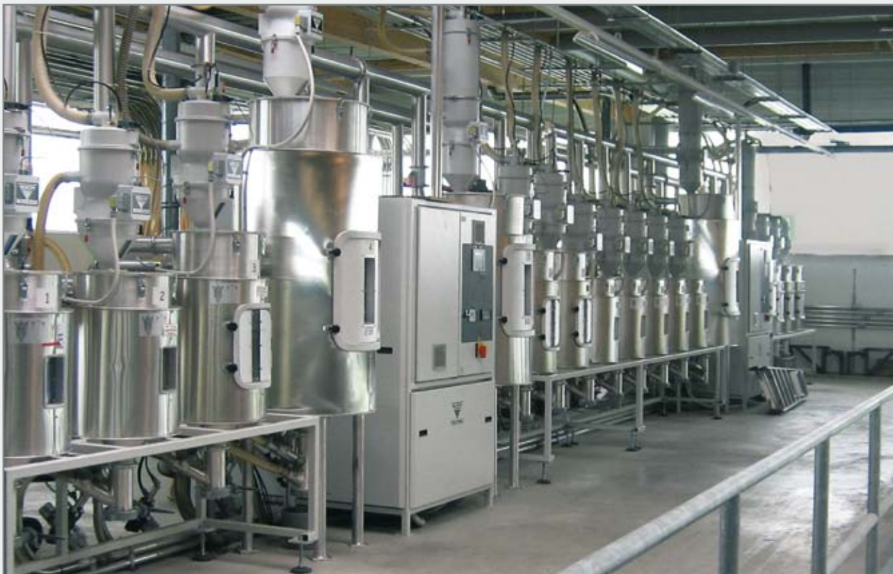
Système de séchage centralisé composé de plusieurs dessiccateurs CKT pour assurer la production de jouets d'un fabricant de renommée internationale
