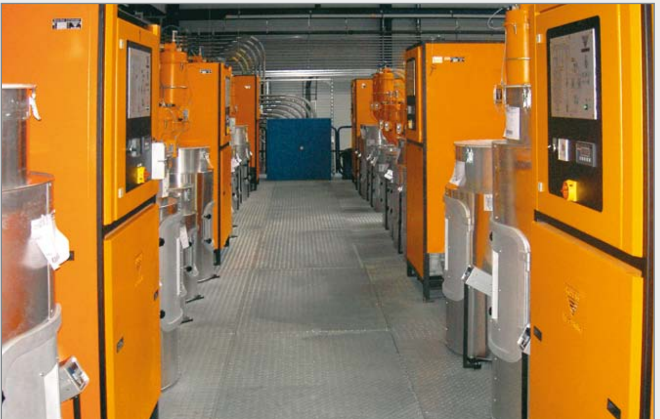
Système de séchage composé de dessiccateurs CKT dans une usine de transformation plastique. Les dessiccateurs assurent le séchage de plastiques hautes performances tels que PPS, PEEK, PEI, PPA.
