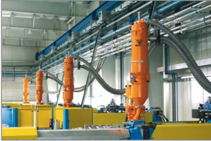
Alimentation centralisée avec KEM-Ma et séparateur A 30 + Z 12
