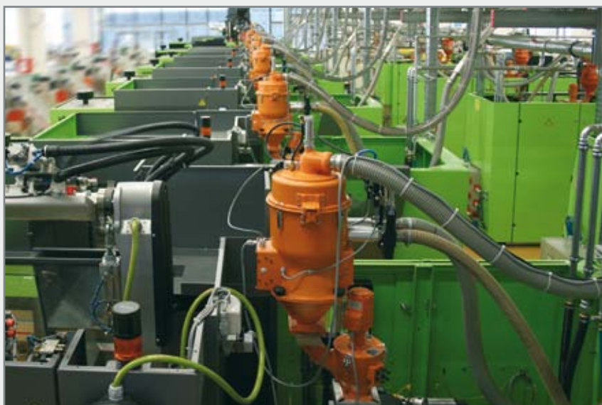
Presses à injecter avec mélangeurs dans une alimentation centralisée pour granulés
