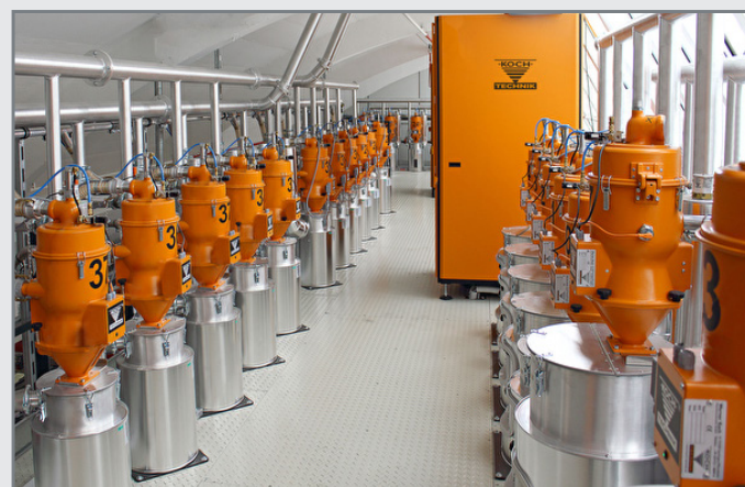
La société Procter & Gamble Manufacturing GmbH est équipée d'un système central de séchage du granulat avec au total trois dessiccateurs à air sec de type CKT et 38 cuves de séchage pour un volume d'air sec pouvant atteindre 1 600 m 3 /h.
