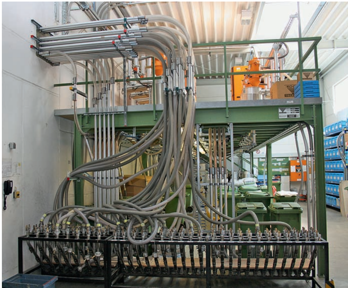
Der Umsteckbahnhof bei Nokutec, dahinter oben die Bühne für die zentrale Trocknungsanlage von Koch: Arbeitserleichterung und Qualitätssprung
