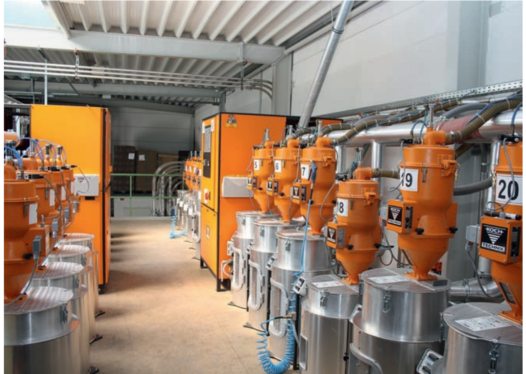
Die zentrale Trocknungsanlage: Zwei Trockenlufttrockner mit 300 und 500 m 3 Trockenluft pro Stunde und mittlerweile 20 angeschlossenen Trocknungsbehältern befüllt durch Förderabscheider
